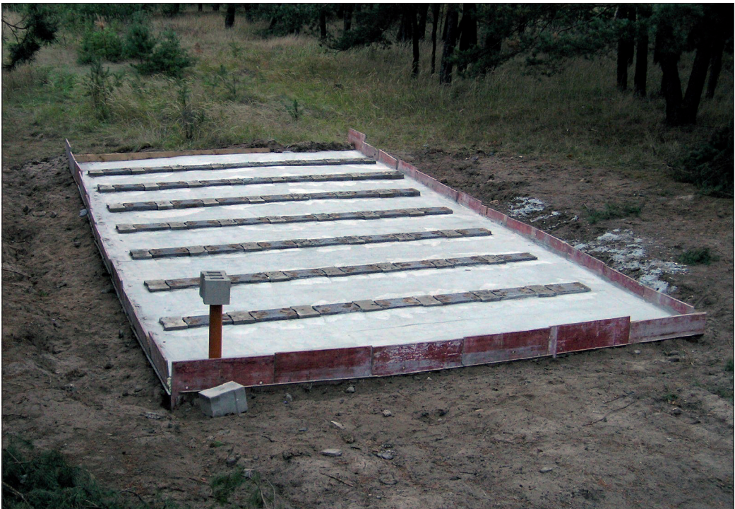
Abb. 5. Geschlossene Beton-Kellerdecke mit sieben Reihen eingebauter „Winklersteine“ und eingesetztem Belüftungsrohr. Aufn.: G. MAETZ.
