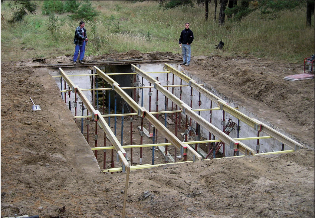
Abb. 4. Ehemaliger Kartoffelkeller mit geöffneter Decke und eingebrachten Stützen in Vorbereitung zum Aufsetzen der Deckenträger. Aufn.: G. MAETZ.
