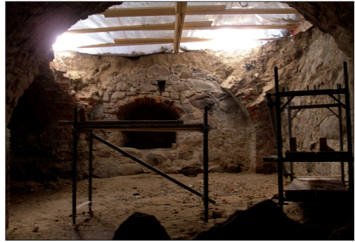
Abb. 2: Beräumter Gewölbeeinbruch. (Foto: J. Berg)
