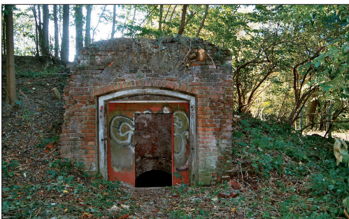
Abb. 11: Sanierungsbedürftiger Kellerabgang. (Foto: J. Berg)
