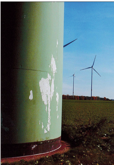
Abb. 6: An der alten Fuhrländer-WKA (Nr.: FL 79) blätterte der blassgrüne Anstrich nicht nur am Mastfuß, sondern auch weiter oben großflächig ab.
