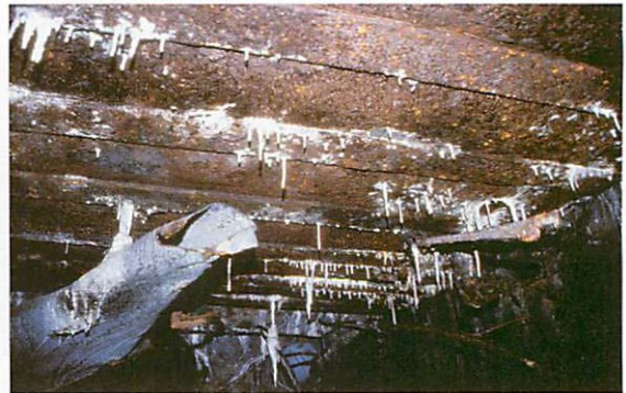
Abb. 6. Stark verrostete, teils verbogene und dadurch beste Fledermausverstecke bietende Eisenbewehrungen mit Stalaktitenbildungen an der Decke einer tiefergelegenen Sektion eines der Häuser in der Maybach-Bunkeranlage I. Aufn.: R. BAIER/Rangsdorf
