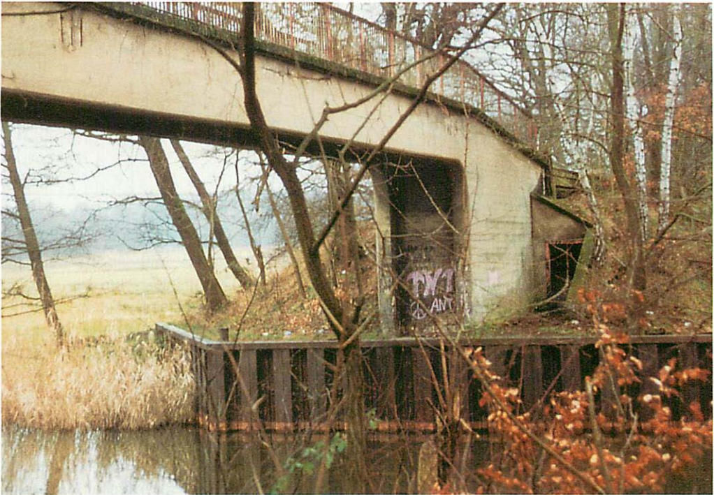
Abb. 5. Pintschbrücke Fürstenwalde/Spree. Rechts neben dem Pfeiler der zimmertürgröße, völlig offene Eingang in die Brückenkammer. Aufn.: LUTZ FITTERMANN, Dez. 1994
