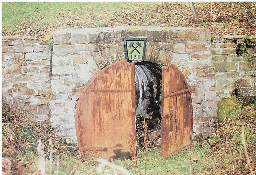
Abb. 5. Alter Bergwerksstollen bei Morsbach, gesichert mit einem Blechtür und einer dahinter liegenden abschließbaren Blechtür (nicht sichtbar). Den Fledermäusen reichen oben erkennbare Spalten zum Ein- und Ausfliegen. Aufn.: C. BUCHEN
