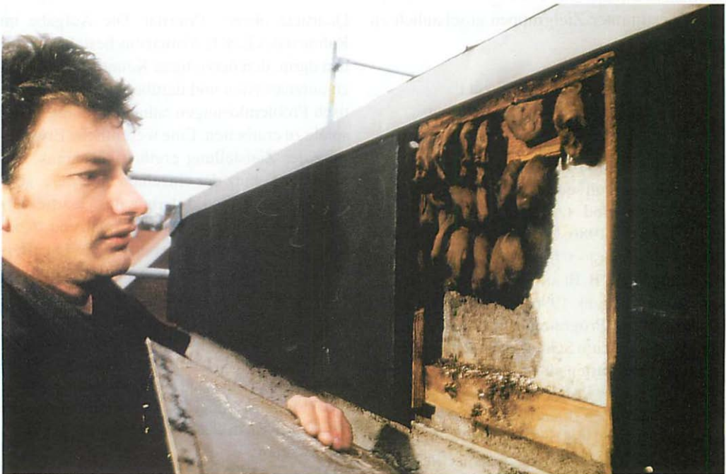
Abb. 5. Eine Winterschlafgesellschaft von Abendseglern ( Nyctalus noctula ) hinter einer Eternitverblendung - entdeckt während Bauarbeiten an einem Hochhaus-Flachdach, das mit einem Satteldach aufgerüstet werden soll. Aufn.: THOMAS STEPHAN
