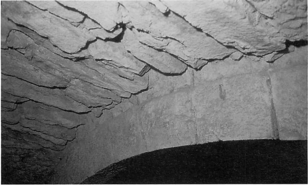
Abb.4. Detailaufnahme einer Kappe mit Gurtbogen. Deutlich sind die starken Mörtel auswaschungen in den Fugen auszumachen. Aufn.: H. MAUS
