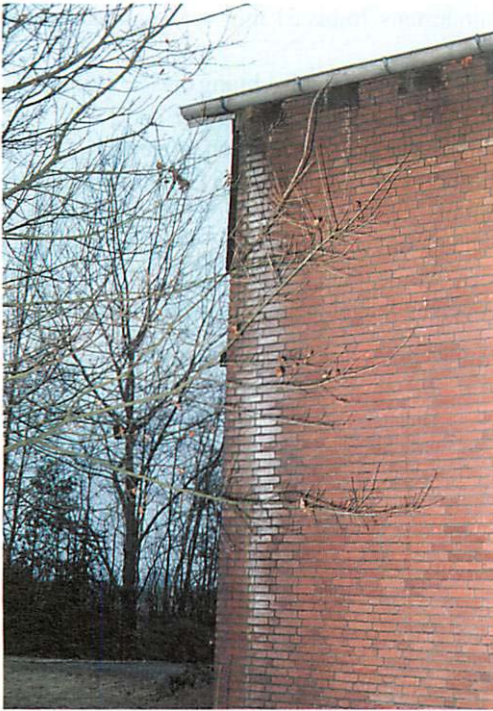
Abb. 5. Durch Urinfluß entstandener Streifen unterhalb einer ehemaligen Ausflugsöffnung. Aufn.: UWE ZIEGELER, Teufelsmoor, 20.1.1996
