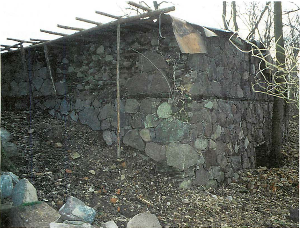
Abb. 2. An den Hang gesetzter Eiskeller nach ersten Sicherungsmaßnahmen, von der Rückseite betrachtet; rechts erkennt man den unteren/hinteren Eingang. Aufn.: U. GRÜTZMACHER
