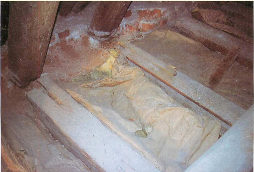
Abb. 1. Blick in den Fehlboden der Kirche Lauterbach nach dem Entfernen des Fußbodens. Das verpackte Isoliermaterial befindet sich noch zwischen den Deckenbalken. Aufn.: G. DINGER, 7.11.2000
