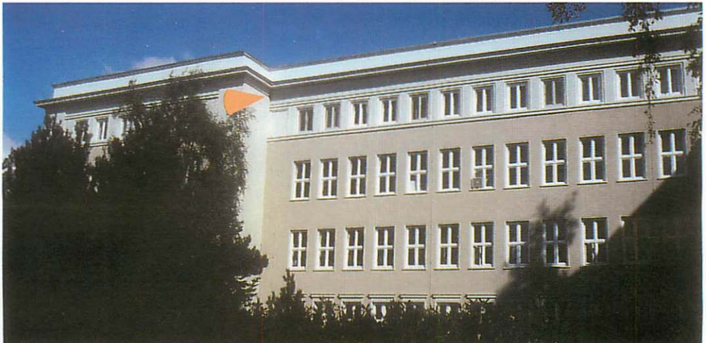
Abb. 8. Rostock, Gebäude Universitätsklinikum - Schillingallee – westlicher Bereich. Der Pfeil weist auf den Einflug zum 1995 entdeckten Winterquartier (Fugenspalte in der Negativecke). Am 28.1.1995 wurde hier ein 2 m langer, 1 m hoher und etwa 25 cm tiefer Hohlraum in der Stoßfuge der beiden Gebäude bei Kernbohrarbeiten entdeckt. Der Einflugspalt wurde 1996/97 im Zuge von Bauarbeiten verschlossen und am 8.X.1998 wieder geöffnet. Eine Wiederbesiedlung des Quartiers war bereits im August 1999 feststellbar. Aufn.: U. HERMANN'S
