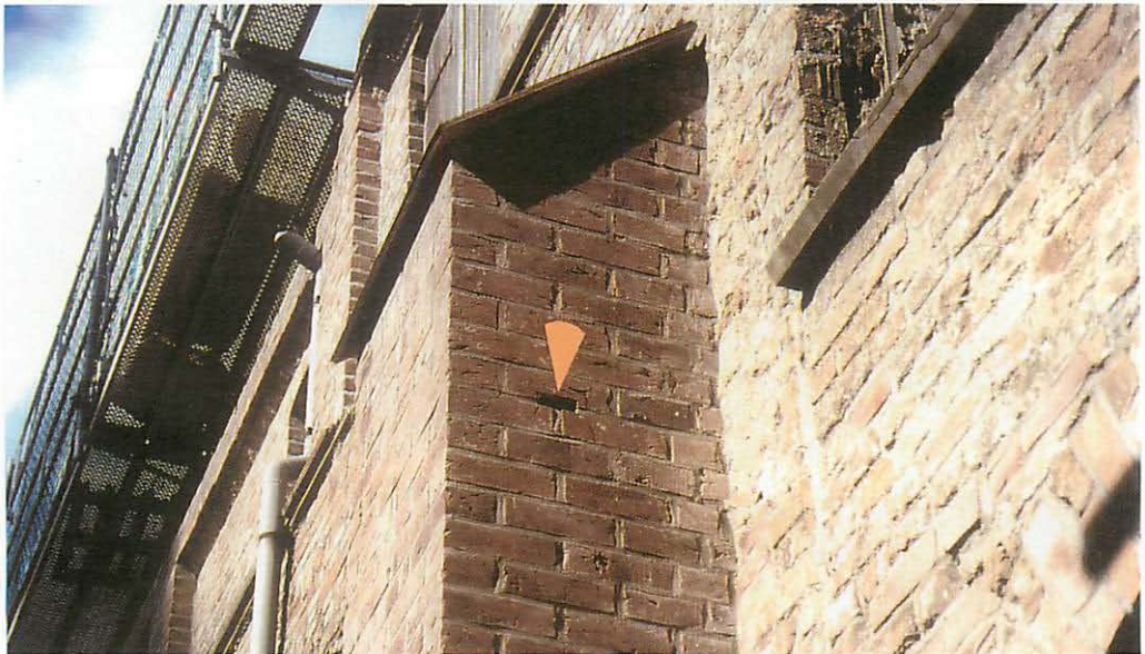
Abb. 11. Ehemaliges Kloster „Katharinenstift“ Rostock – Nahaufnahme eines Gebäudepfeilers. Hinter dem horizontalen Einflug (Pfeil) befindet sich der Hohlraum, in dem durch Endoskopie bereits im August 1999 Fledermäuse festgestellt wurden. Aufn.: U. HERMANN'S
