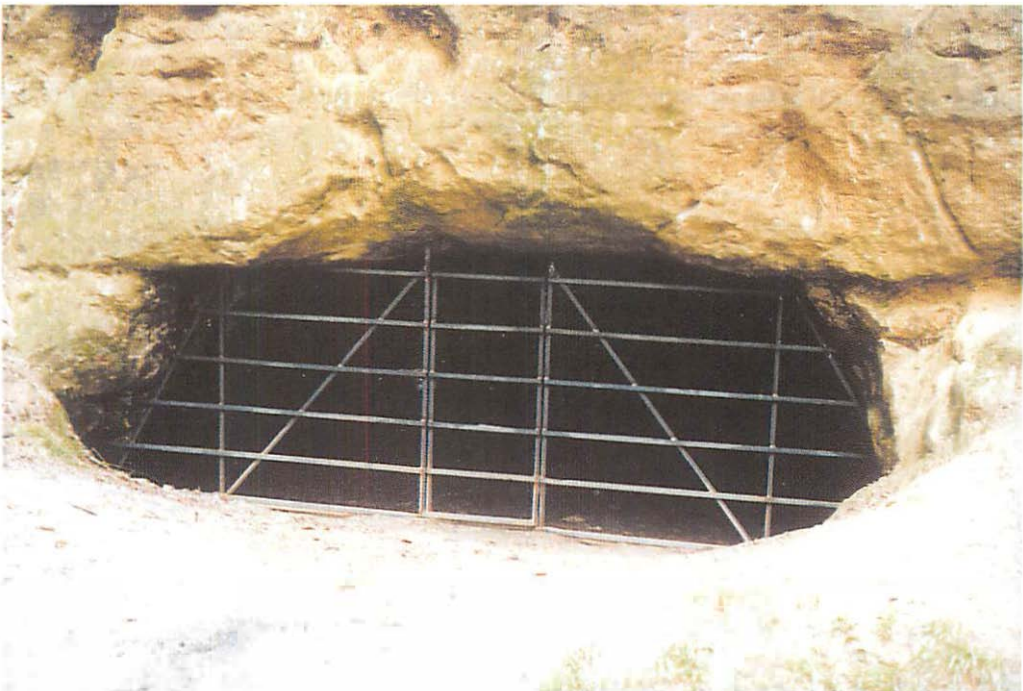
Abb. 2. Das im Sommer 2000 installierte Metallgitter am Eingang zu den Stollen Riedelova Höhle bei Pysk in Tschechien, in dem auch die Kleine Hufeisennase überwintert. Aufn.: Ing. ZDENĚK VITÁČEK
