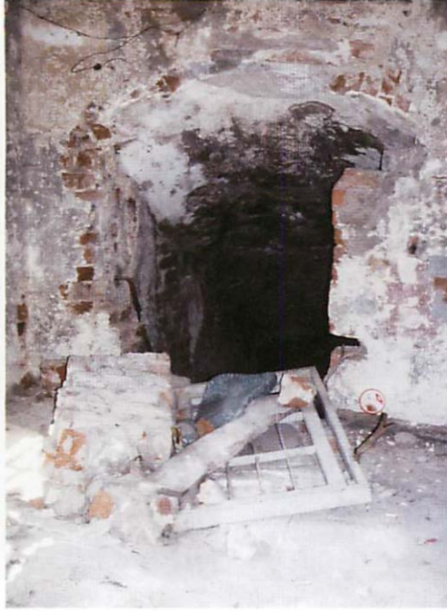
Abb. 7: Herausgebrochene Stahlgittertür am Eingang des Kellergewölbes. Aufn.: S. HAHN
