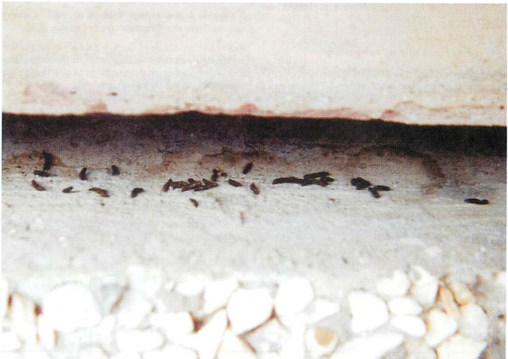
Abb. 1. Kot- und Urinspuren einer kleinen Fledermausart in der Außenwandfuge eines Plattenbaus. Aufn.: J. BERG
