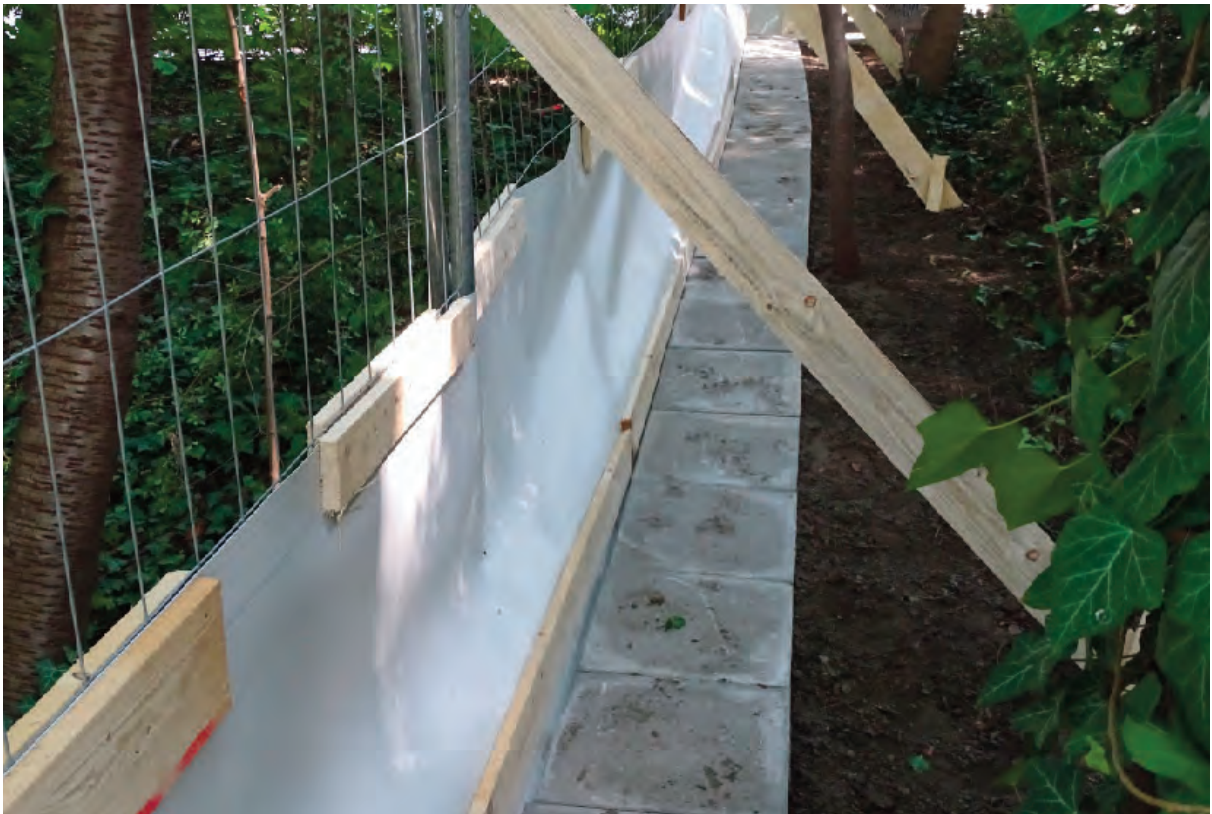
Abb. 8: Schutzzaun an der Böschung, bodenseitig beschwert.
