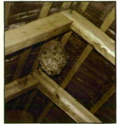
Abb. 3: Das Dachgebälk im Giebelraum zählt zu den bevorzugten Stockstandorten. Foto: J. Eder
