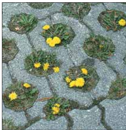
Abb. 4: Die Löcher der Autoabstellfläche eines Parkplatzes können nur von sehr robusten Pflanzen bewältigt werden (Leonding, Rathaus).
