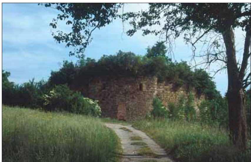
Abb. 7: Im unteren Teil der so genannten Maier-Wiese liegt der frei zugängliche Turm Nr. 20 der Maximilianischen Verteidigungsanlage. Das Mauerwerk ist sehr stark von Gebüsch und Mauerritzenpflanzen bewachsen. Foto: W. Bejvl
