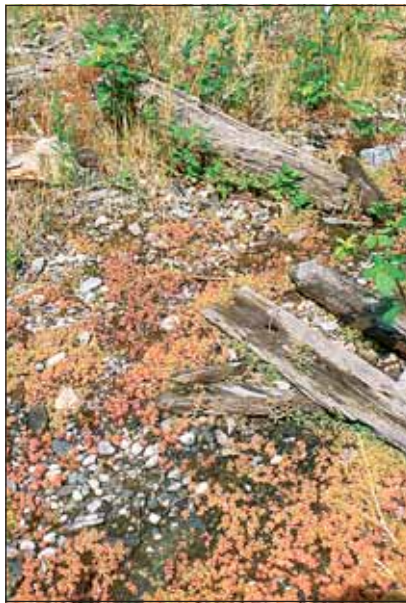
Abb. 7: Ein Großteil des zerfallenden Asphalts ist mit Weißer Fetthenne bestanden.
