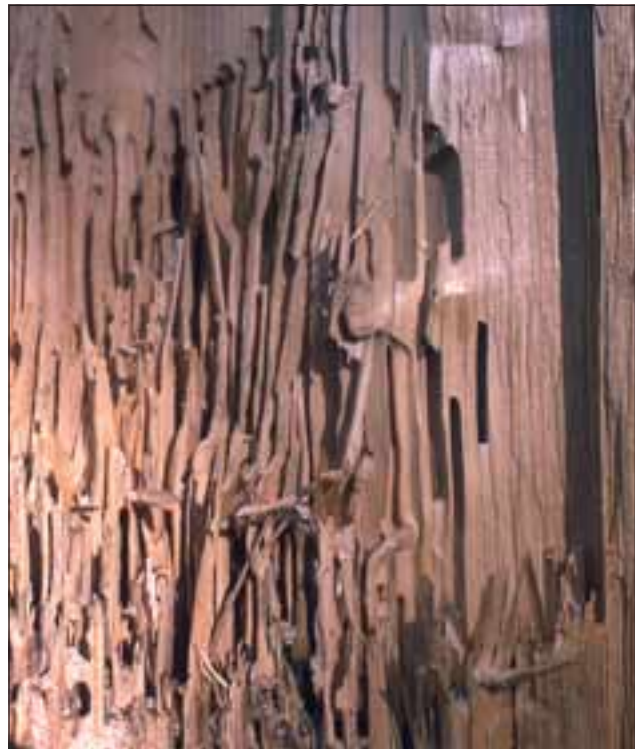
Abb. 2: Im Holz erkennt man deutlich die von den Ameisen herausgenagten Spalten.
