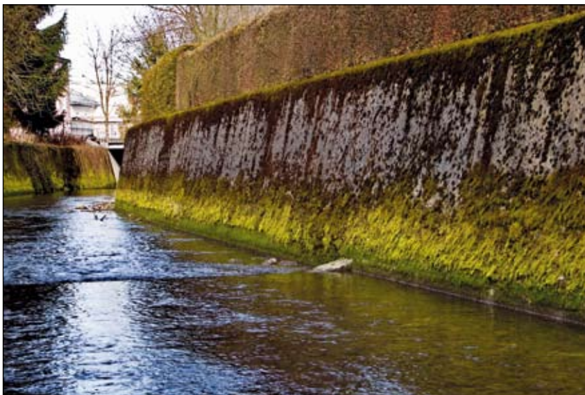
Abb. 1: Die Breitsach in Ried i. I. bei Normalwasser. Der Bewuchs durch unterschiedliche Moose ist deutlich zu sehen. Die trockene Mauermitte fällt auf.
