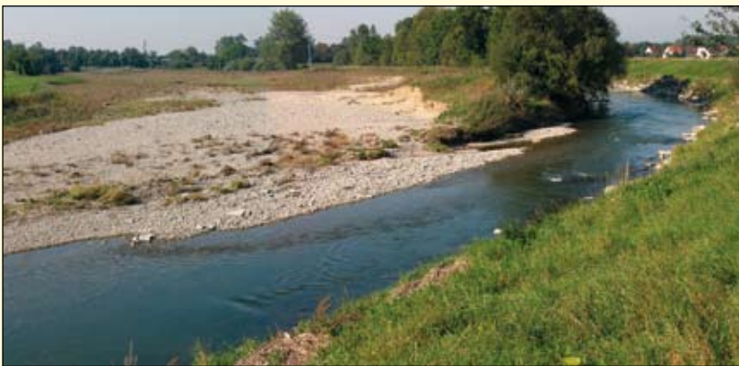
Abb. 6: Zustand etwa 9 Monate nach Herstellung (24. 9. 2007). Besonders auffallend ist die Ablagerung der großen Schotterbank am linken Kremsufer sowie der Böschungsabbruch an der linken Seite der Insel.
