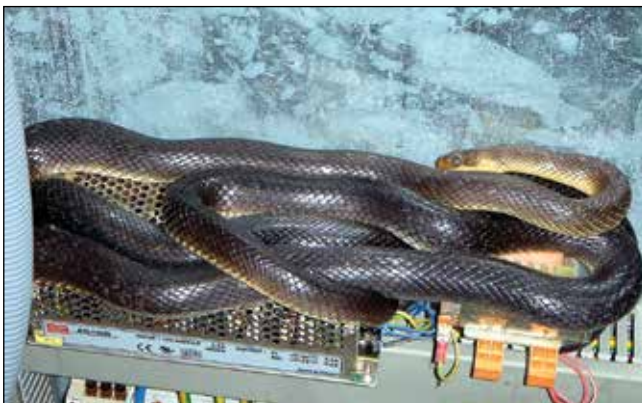
Abb. 8: Besonders scheinen Äskulapnattern die nicht ungefährlichen Schaltkästen zuzusagen. Zwischen 2011 und 2013 wurde ich über ein dutzendmal um Hilfe gebeten, die Nattern zu entfernen.
