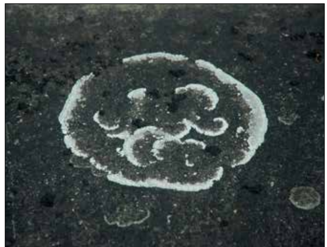
Abb. 53: Die Mauerflechte ( Protoparmeliopsis muralis ) – auf einer Betonmauer im Vormarkt Ufer in Obernberg am Inn (Bestimmung durch F. Berger, Kopfing)
