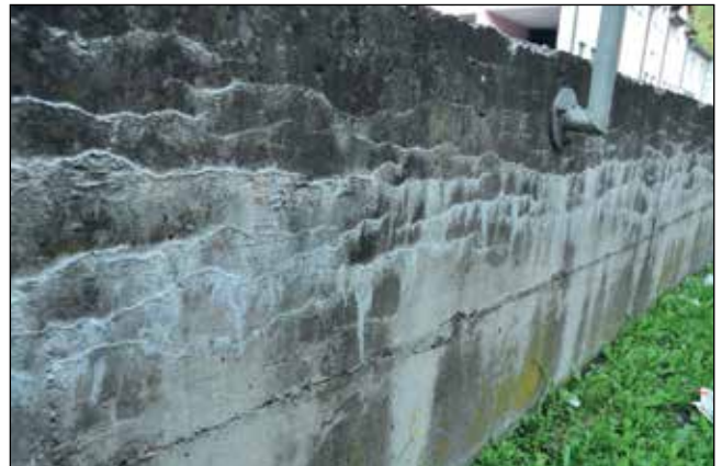
Abb. 15: Kalkausblühungen haben nichts Botanisches an sich – hier an der Betonmauer an der Hauptstraße in Helfenberg im Mühlviertel
