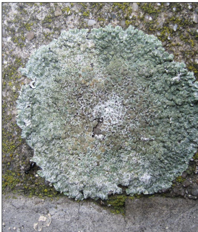
Abb. 25: Die gewöhnliche Mauerflechte ( Protoparmeliopsis muralis ), fotografiert im Stadtbereich, zeigt hier eine beginnende Schädigung. Die Lagerstruktur wird zentral unruhig, erste Ausbleichungen werden sichtbar; das Lager verliert dort seinen Kontakt mit der Unterlage und wird in diesem Bereich bald ausfallen. Dieses Spiel von Absterben und Neubesiedlung kann sich mehrfach wiederholen, sodass konzentrische Flechtenkreise entstehen können.
