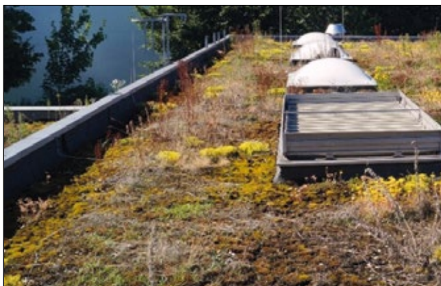
Abb. 15: Dachfläche mit artenreicher Krautschicht Foto: Gregor Auinger
