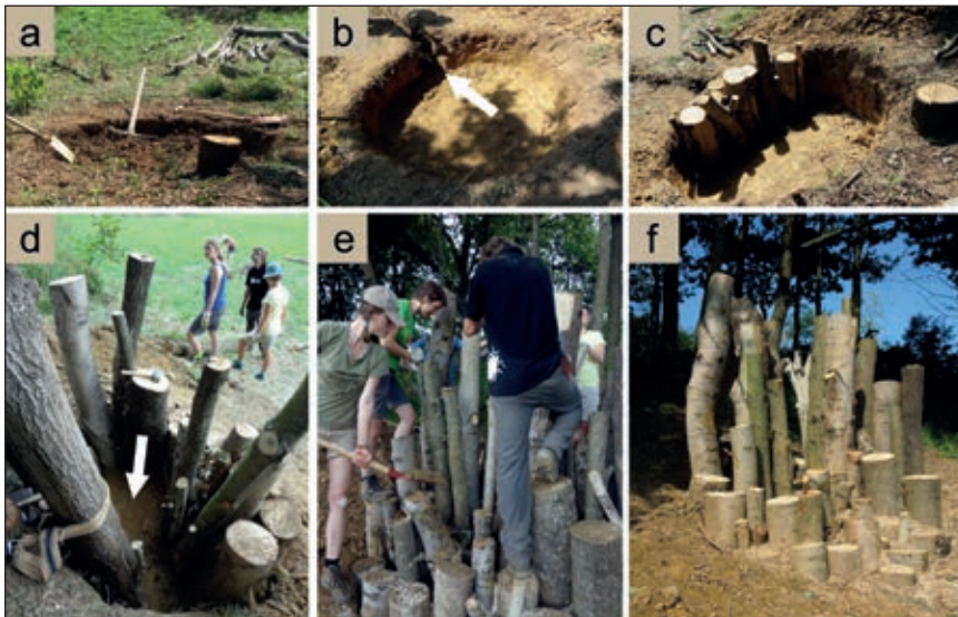
Abb. 8: Bilddokumentation vom Bau einer Käferburg. (a) Grube ausheben, im Vordergrund der Stumpf einer gefällten Eiche; (b) die gewünschte Tiefe der Grube von circa 70 cm ist erreicht, da an dieser Stelle der Boden sehr lehmig war, wurde eine Drainage installiert (weißer Pfeil); (c) Setzen der ersten Reihe kürzerer Stammstücke; (d) Zwischenstand der gesetzten Stammstücke, der weiße Pfeil zeigt auf die zentrale stammfreie Zone, die als attraktiver Eiablageplatz und Verpuppungsort der Larven dienen soll; (e) die Lücken werden mit Erde verfüllt und zeitgleich durch Stampfen verdichtet – dies dient der Stabilisierung, besonders der weit herausragenden Hölzer; (f) fertige Käferlarvenburg aus Eichen- und Pappelstämmen.
