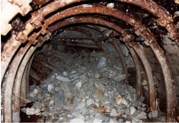
Abb. 12: Stollenverbruch im Stahlausbau
