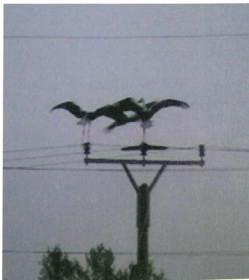
Abb. 9: Hier wird die Notwendigkeit der in Abb. 8 beschriebenen Maßnahme eindrucksvoll dokumentiert. Zwei Störche ( Ciconia ciconia ) landen abends auf einem so gesicherten Mast auf benachbarten Isolatoren und berühren sich. Ohne die Isolierung der mittleren Phase würden beide zu Kurzschlussopfern. Queichtal, Rheinland-Pfalz. Videoaufnahme: M. Fangrath
