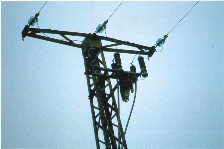
Abb. 7: Metall-Endmast auf einer Waldlichtung. Die Leiterseile werden zunächst unisoliert nach unten geführt, die Phasenabstände werden enger. Das Uhu-Weibchen ( Bubo bubo ) starb durch Auslösung eines Kurzschlusses und blieb hängen (Befundung des geborgenen Vogels durch D. Haas). Haigerloch-Owingen, Baden-Württemberg, 13.5.1984. Bericht: Herbert Fuchs, Foto: D. Haas.
