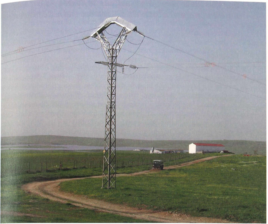
Abb. 10: Schutzhauben aus Blech und abgehängte Isolatoren sowie Spiralen an den Leiterseilen sollen Stromschläge bzw. Drahtanflüge verhindern. Foto: Gerd-M. Heinze
