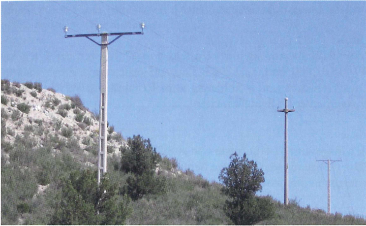
Abb. 1: Stahlbetonmast mit kurzen Stehisolatoren an der Mittelspannungsfreileitung Monegrillo-Osera, Aragon, Spanien. Foto: Gerd-M. Heinze
