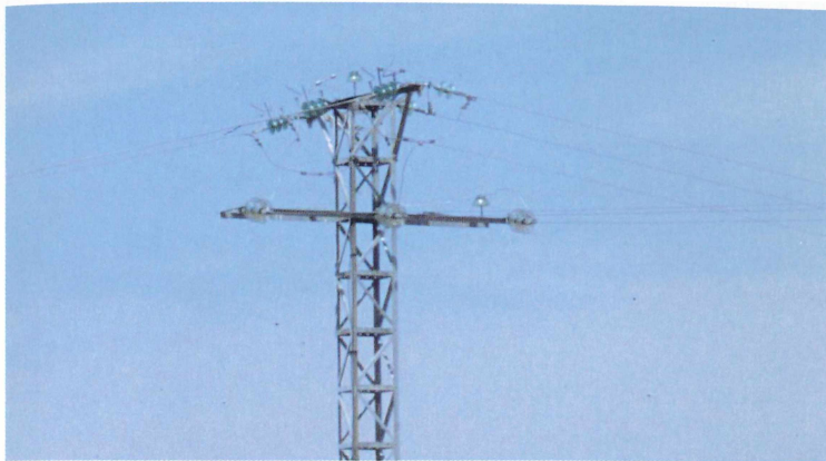
Abb. 7: Sehr gefährlicher Mittelspannungsmast. Foto: Gerd-M. Heinze
