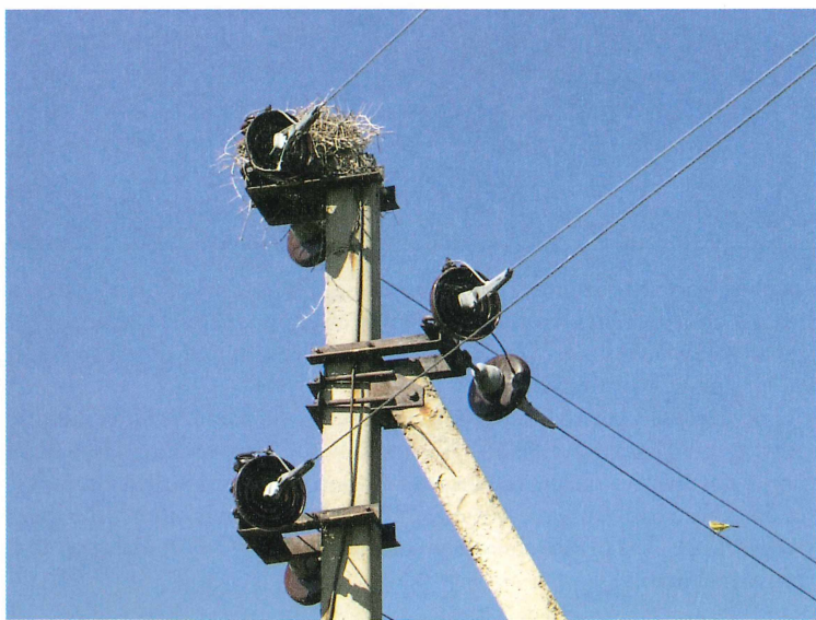
Abb. 3: Mittelspannungsmasten an der Strecke Karazhar bis Schutzgebietsgrenze: (a) abgebaute Mittelspannungsleitung mit Sitzstangen in kasachischer Steppe, (b) Nest an höchst gefährlicher Stelle zwischen Abspannisolator, Stützisolator und Mastkopf. Fotos: Ulrike Lasch
