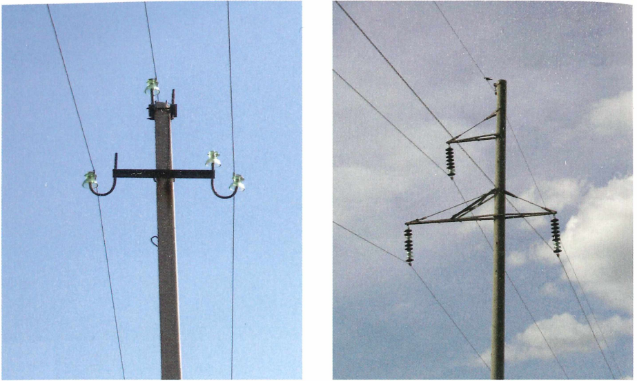
Abb. 5: (a) Mittelspannungsmast und (b) Hochspannungsmast in Kurga-Süd. Fotos: Ulrike Lasch
