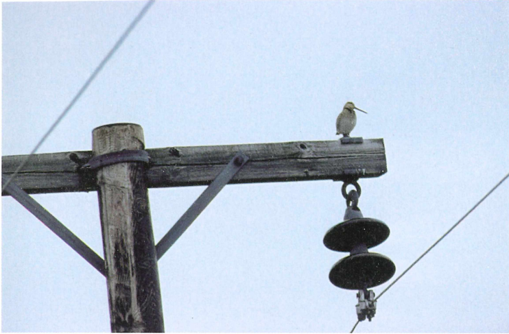
Abb. 4: Eine Bekassine ( Gallinago gallinago , L. 23-28 cm, Spannweite 39-45 cm) bei der Rast auf einem sicheren Holzmasten mit Hängeisolatoren. Myvatn-See, Island, 17.06.05, Foto: D. Haas
