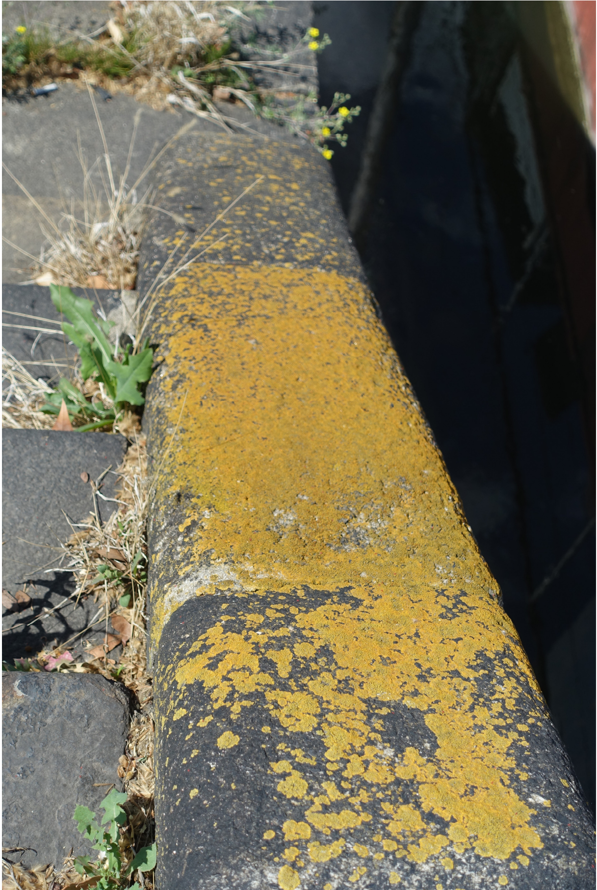
Abb. 5. Calogaya decipiens flächendeckend an einer Ufermauer
