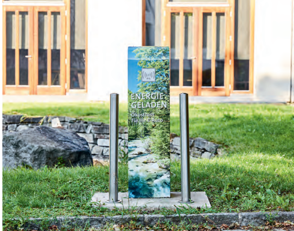
E-Ladestation vor der ÖBf-Unternehmenszentrale in Purkersdorf.
