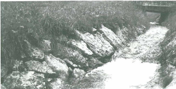
Die Verbauung erfolgte mit groben Wasserbausteinen und durch Sohlstufen. Diese Art gibt die Gewähr für ausreichende Fischunterstände
