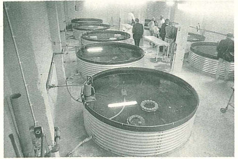
Zuchtanlage für Süßwassergarnelen in Simontorp
