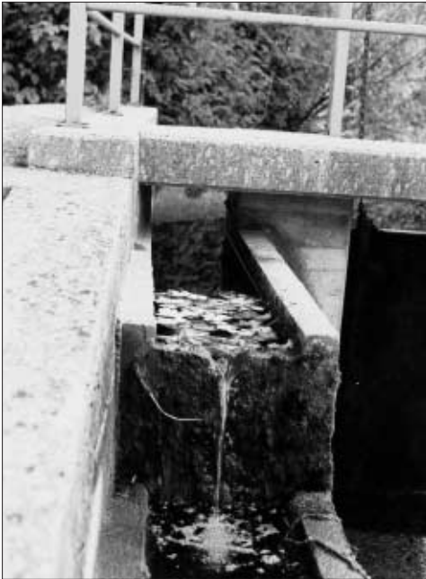
Foto 3: Fischwanderhilfe, Altbestand – oberstes Becken.
