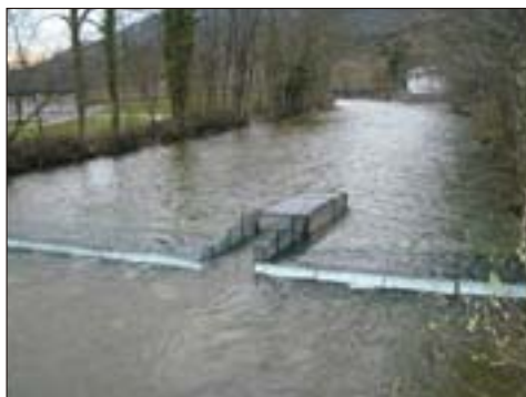
Abb. 2: Dynamisches Fischwehr mit integriertem Reusenkasten zum Fang stromaufwärts wandernder Fische in der Seeache
