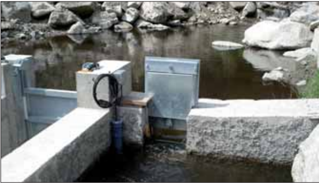
Abb. 2: Der Wehrschütz mit der Restwasser-Öffnung, vom Fischeaufstieg aus gesehen. Der Wehrschütz ragt 12 cm aus dem Blechkasten nach unten heraus. Die elektrische Leitung führt in den Blechkasten, in den die Schützentafel hochgezogen wird.
