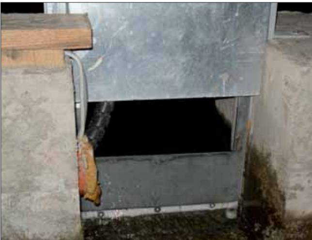
Abb. 3: Durch eine elektrische Vorrichtung ist der Wehrschütz in den Blechkasten hochgezogen worden (die große Schraube in der Mitte des Schützens ist verschwunden). Die Öffnung für das Restwasser wurde um 12 cm angehoben, in den Fischeaufstieg rinnt kein Wasser mehr!
