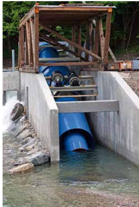
FAS vom Typ Hydro-Connect am Beispiel der Anlage an der Jessnitz (in Bau). Foto: Clemens Ratschan
