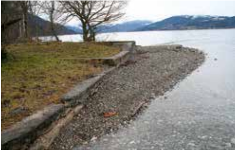
Abb. 5: Baufällige Ufermauer an der Mündung des Alexenauerbachs in den Attersee vor dem Rückbau.
