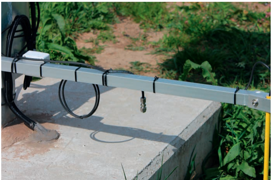
Abb. 2: Auslass mit Blindstopfen, noch ohne Probenahmesystem bzw. Messsensorik.
