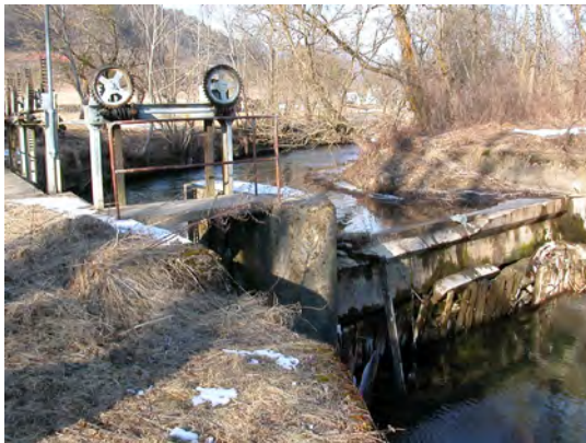
Name bzw. Lage der Anlage
