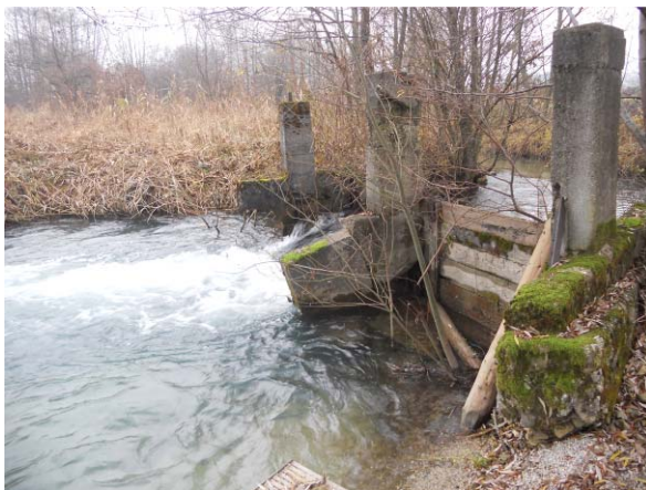
Alte Wehranlage, Absturz und Kolk
