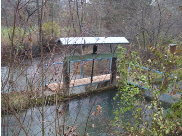
Mobile Absperrung vom Kanal zum Seebach.
