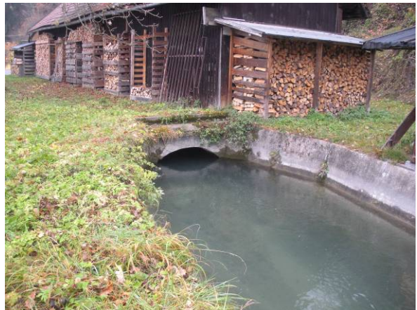
Unterirdischer Eintritt des Kanals in das KW Gregori.
