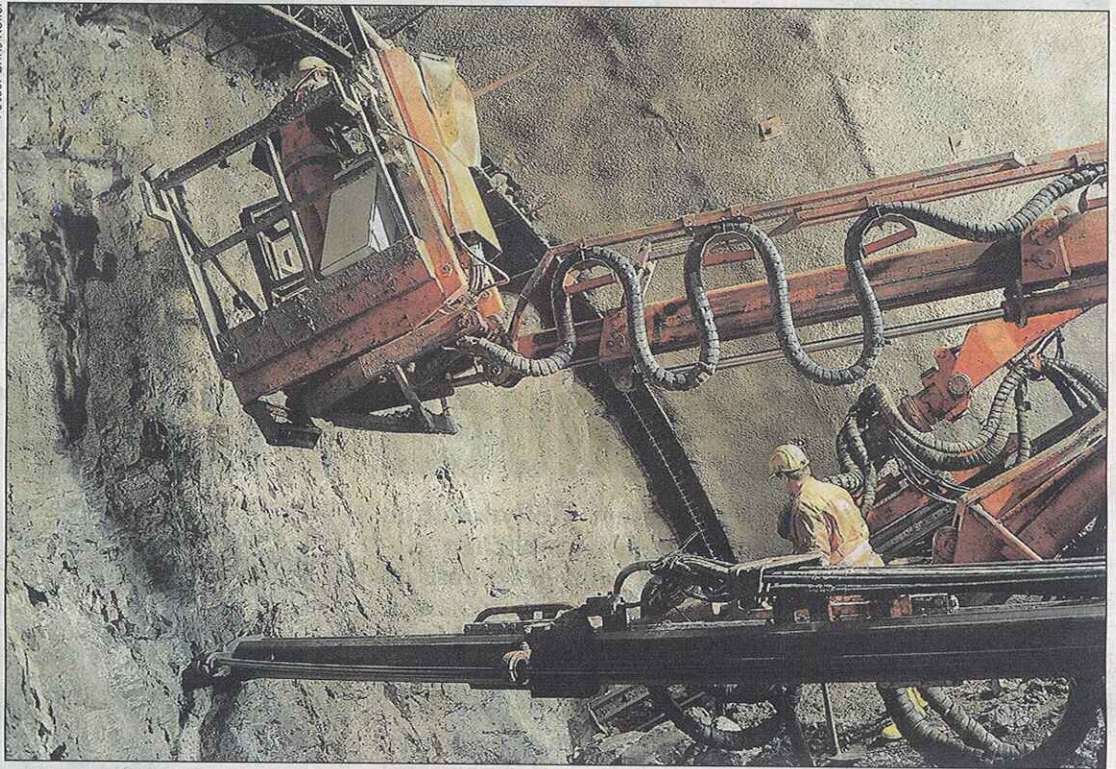
Baustelle für die zweite Autobahn-Röhre des Bosrucktunnels, die 321 Millionen Euro kosten soll
