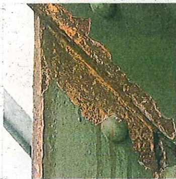
Die Rostschäden auf der 112 Jahre alten Brücke.
