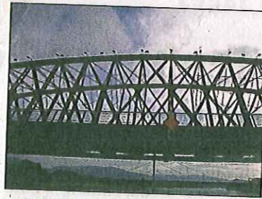
Sanierung notwendig (Weihbold)
