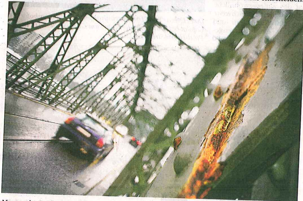
Morgen berät der Linzer Verkehrsausschuss über das Schicksal der vom Rost schwer in Mitleidenschaft gezogenen Brücke.
