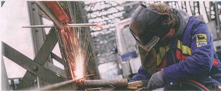
Die 114 Jahre alte Eisenbahnbrücke gilt als sanierungsbedürftig. Deshalb wird das Bauwerk laufend kontrolliert und repariert. Fotos: Weibbold
