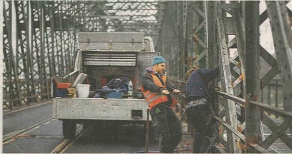
Dass die Eisenbahnbrücke abgerissen wird, ist fix, nur das Wann ist unklar. (vowe)
