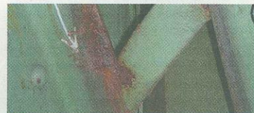
Der Rost setzt dem Eisen schwer zu.
