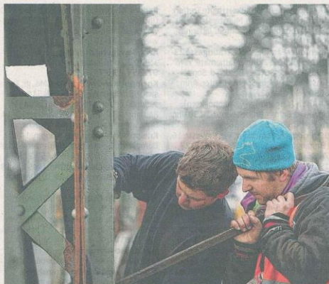
Die Zukunft der Eisenbahnbrücke bleibt weiterhin unklar.
