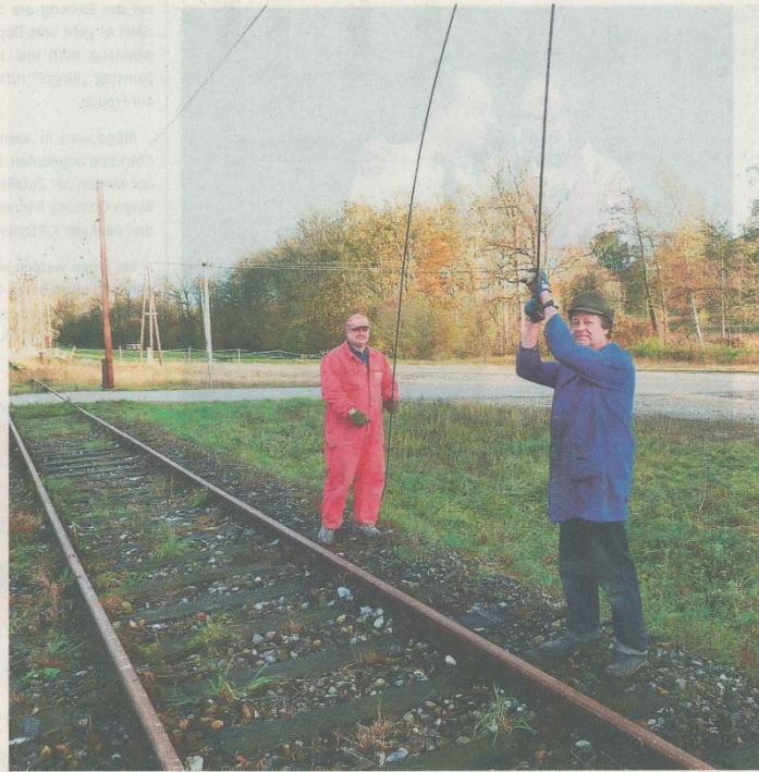
Die Reste der Oberleitung hängen lose herunter. Die ÖBB beginnen mit der Demontage.
